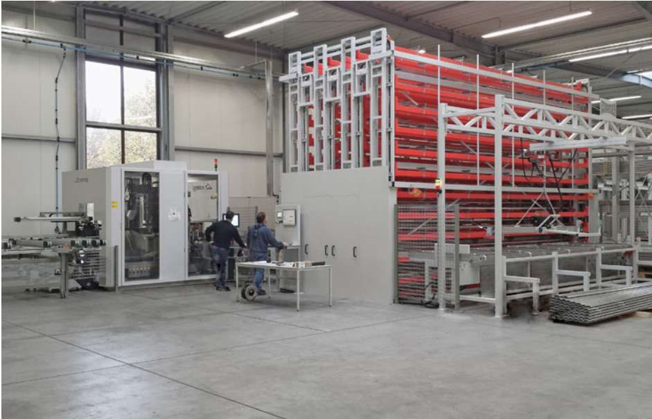
Ein Paternoster Stangenlager der Karl Pflumm GmbH belädt vollautomatisch das Emmegi +Quadra Profilmbearbeitungszentrum im Hintergrund.
